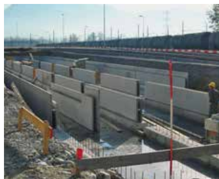
Einsatz bei Retentionsbecken
