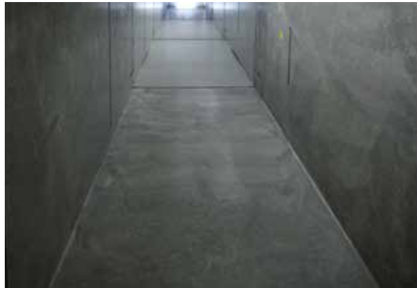
Der fertige Liftschacht mit den eingebauten Ankerschienen ist bereit für den Einbau des Aufzugs. Auf Wunsch sind Hülsen für den Einbau eines Schachtgerüsts möglich.
